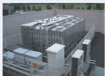
RI排水処理設備
